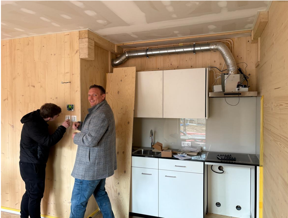
Motorloze ATAG afzuigkap (200 m 3 /uur) aangesloten op DUCO ventilatiebox (C.5b)
